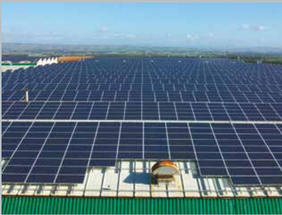
Un impianto fotovoltaico riqualificato da TEKNE ESCo (Foto TEKNE)
