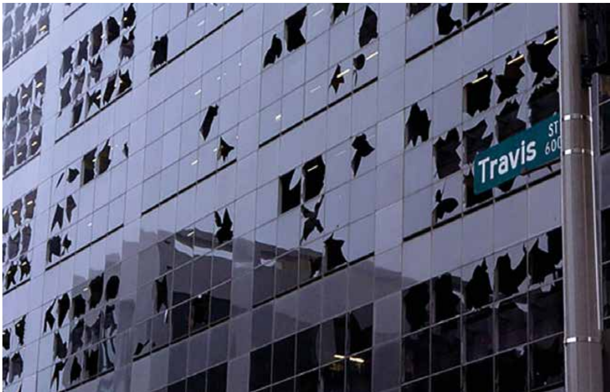
Figura 12 – Esempio di danni provocati da un uragano su una facciata continua.
