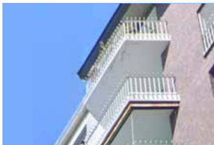
Immagine 03. Balcone realizzato in laterocemento con ringhiera in ferro. Nella zona sottostante il balcone posto all'ultimo piano sono visibili alterazioni cromatiche che evidenziano infiltrazioni idriche dovute alla presenza di soluzioni di continuità sull'elemento di tenuta. Normalmente i fenomeni maggiori sono visibili all'ultimo piano, soprattutto quando è assente in tutto o in parte una protezione superiore. Fonte: google maps
