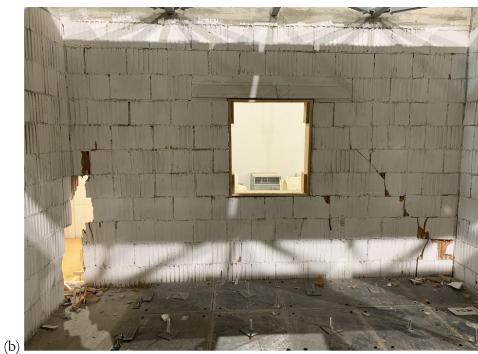
Figura 32 Danno causato dal sisma E4 – RM (fattore di scala 1,50): (a) moto relativo tra i macroblocchi del primo e secondo piano; (b) prospetto D piano secondo (interno).
