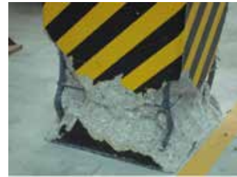
(A) – DISTACCO DEL COPRIFERRO E INSTABILITÀ LOCALE DELLE BARRE LONGITUDINALI – EMILIA 2012
