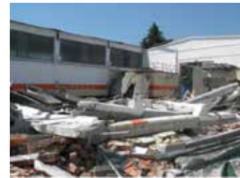
(B) – COLLASSO GLOBALE DELLA STRUTTURA CONSEGUENTE ALLA ROTTURA DELLA BASE DEI PILASTRI – EMILIA 2012
