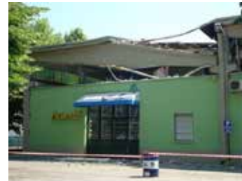
FIGURA 3. PERDITA DI APPOGGIO PER SLITTAMENTO DI UNA TRAVE (EMILIA 2012)
