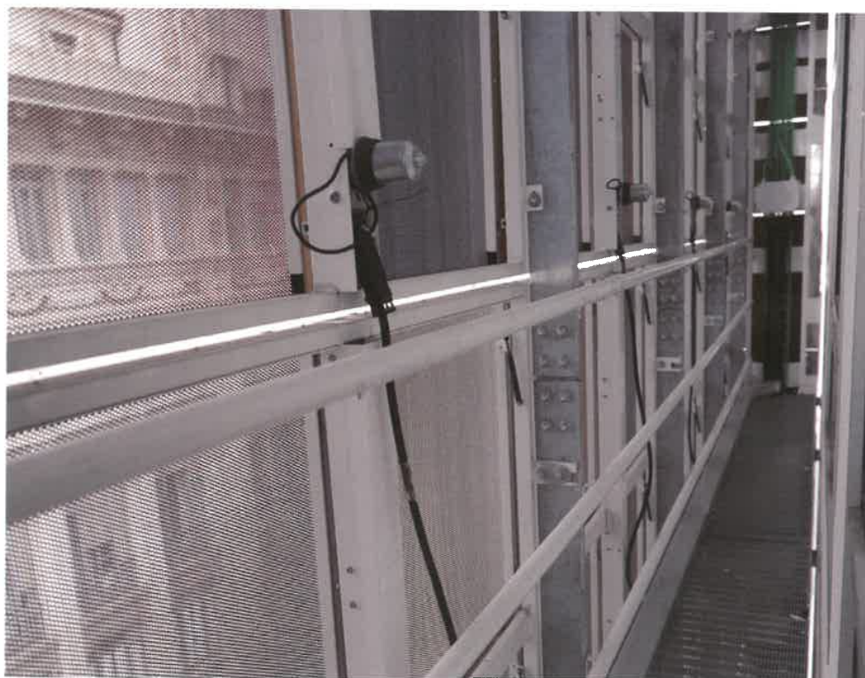
La movimentazione è realizzata con motori elettrici che lavorano sui leveraggi dei vasistas. Il tutto coordinato da un'unità di controllo elettronico.
