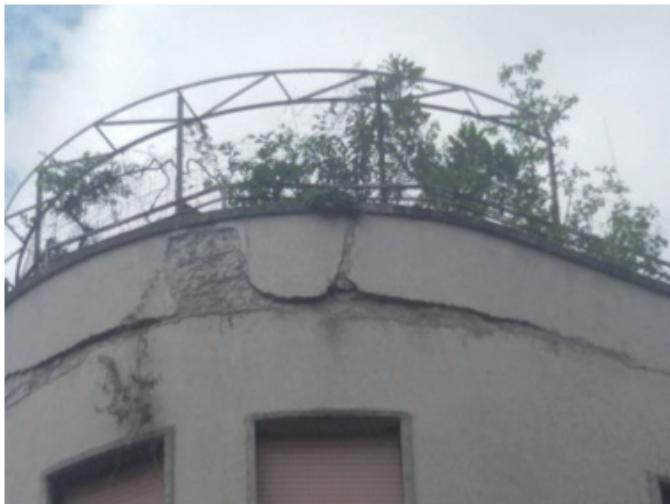
E' visibile la zona parzialmente dislocata. Sono evidenti anche importanti lacune sul parapetto e lesioni fra parapetto e solaio.
