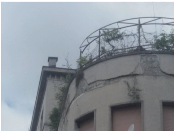
Sono visibili lacune e distacchi in corrispondenza della testata del solaio del terrazzo.
