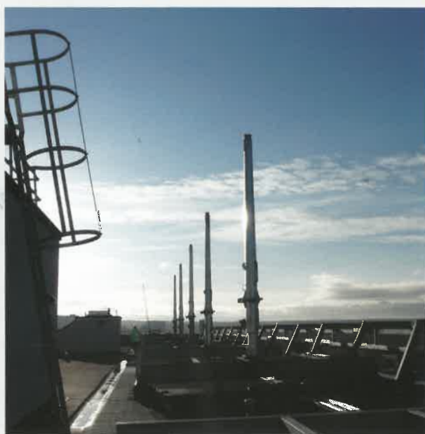
Struttura di supporto di una turbina eolica sulla copertura di un edificio residenziale a Londra. Visti gli esiti positivi della prima installazione, sono state montate altre 7 turbine che complessivamente producono il 5% dell'energia necessaria all'edificio.
