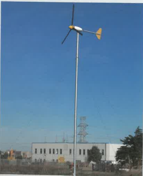
Generatore eolico da 1 kW installato nell'area industriale di Porto Torres (SS).
