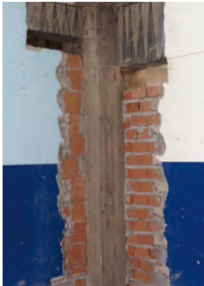
5. Pilastrata tipo al termine dei lavori di incamiciatura e riconnessione delle tamponature.
